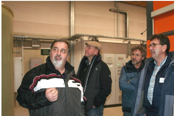
Austausch der Ortsbürgermeister, Volker Wichter aus Neuerkirch erklärt Gottfried Wawers die Heizzentrale des Nahwärmenetzes
