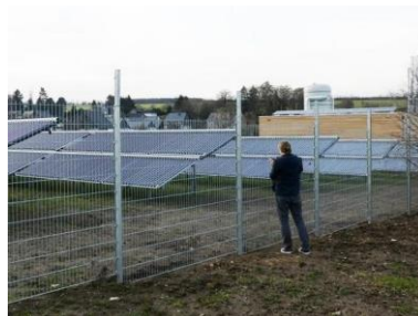
Michael Münch (TSB) vor der Solarthermieanlage in Ellern
